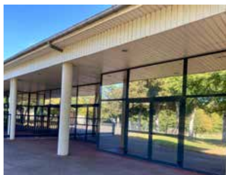
Filtres solaires - Salle annexe et périscolaire
